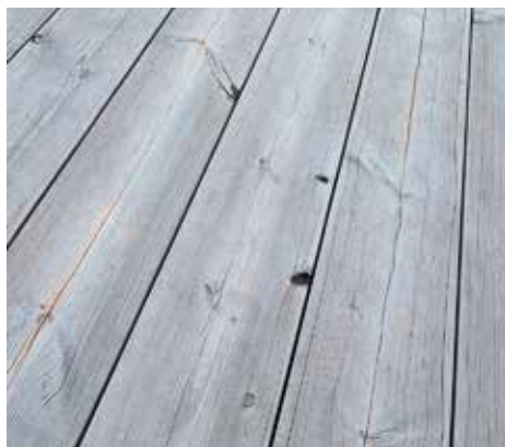
Niezaimpregnowana deska tarasowa Lunawood (Thermososna) 2 lata po montażu. Na powierzchni widoczne są niewielkie pęknięcia włoskowate.
